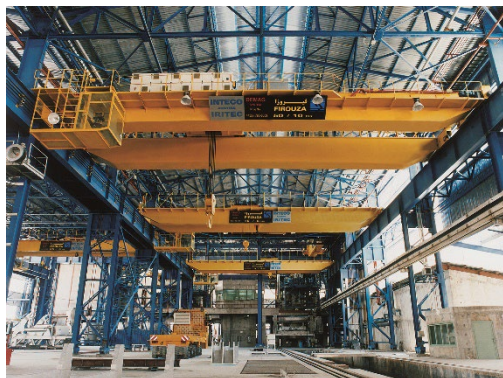
50/10 t x 21.8 m (esfarayen steel co)
